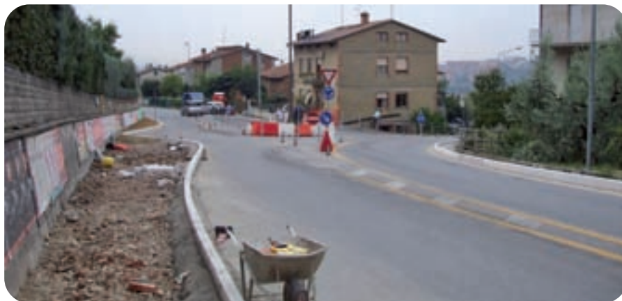
In via Turati è in fase di conclusione la realizzazione di una minirotonda per la messa in sicurezza dell’intersezione stradale e di un marciapiede per il percorso pedonale. L’importo dei lavori è pari a 100.000 euro.
